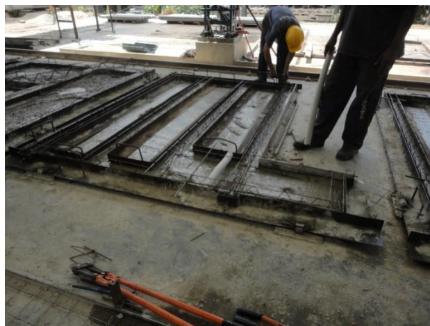
Figura 14 – Colocação da fôrma e da armadura do quadro externo e das nervuras
